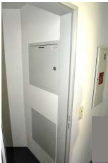
Abstellraum mit Unterverteilungen Elt., Heizung
